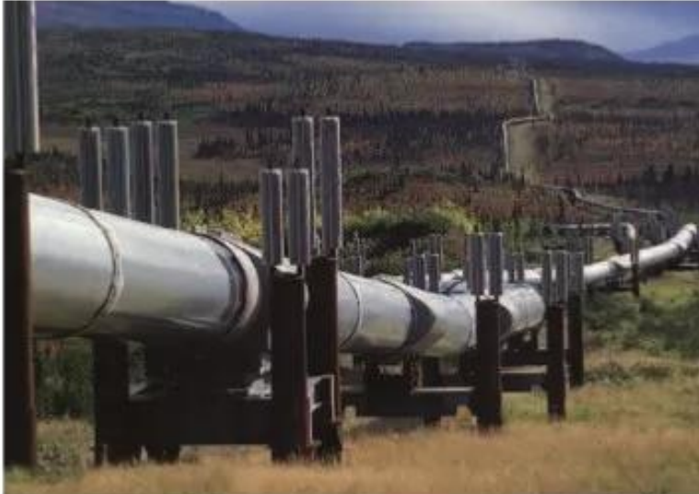
Hình 50.3 - Đường ống dẫn dầu hiện đại, dài 1270 km ở A-la-xca (Hoa Kỳ)
