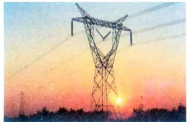
Hình 32.4. Đường dây truyền tải điện cao áp
