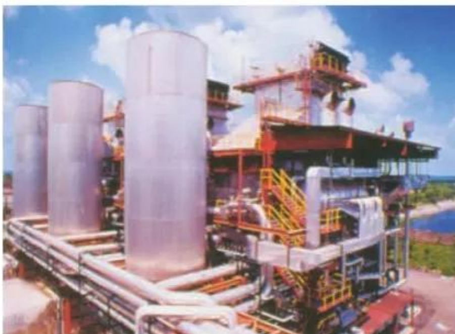
Hình 32.2 - Nhà máy điện khí đốt ở Ấn Độ
