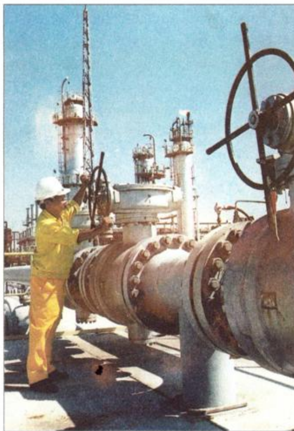
Một đoạn đường ống dẫn khí ở Nhà máy khí Dinh Cố
