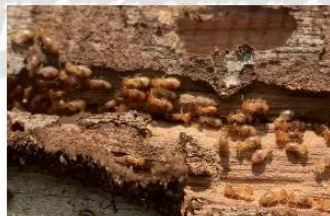
Mối phá hoại công trình xây dựng
